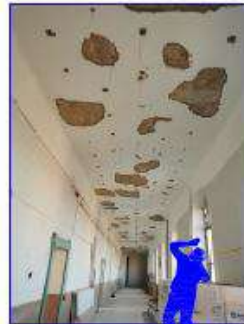
Distacco dell'intonaco a platea
