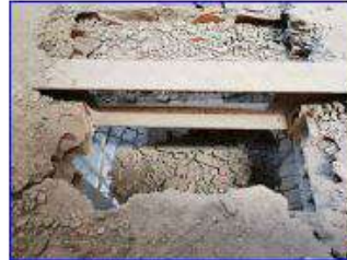
Stondellamenti e dissesti del cond. in laterizio
