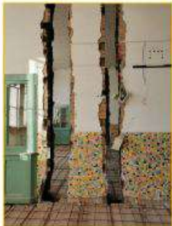
Vuoti verticali nei muri divisorii delle aule
